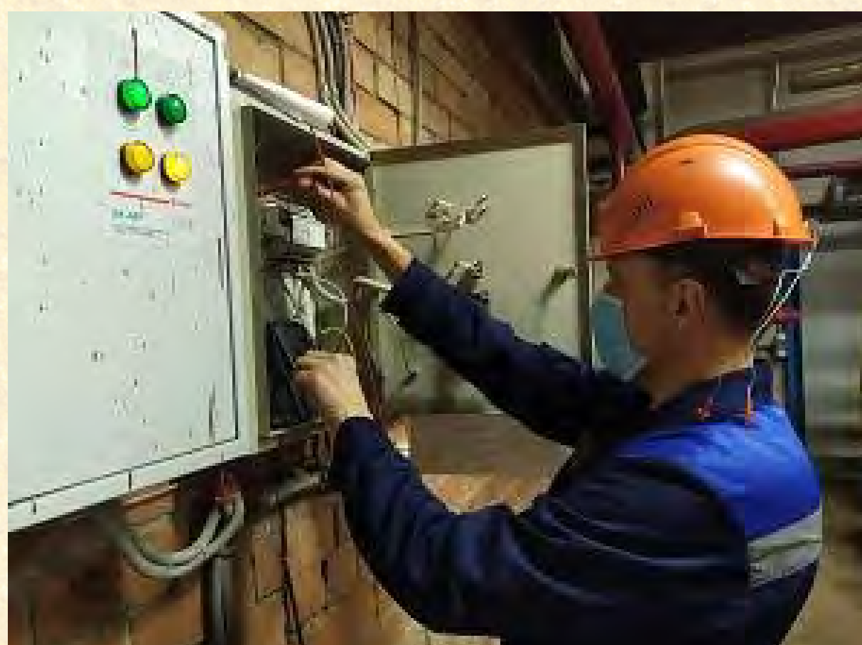
На фото: Специалист КРО ВДПО проводит проверку КИПиА на Комбинате
