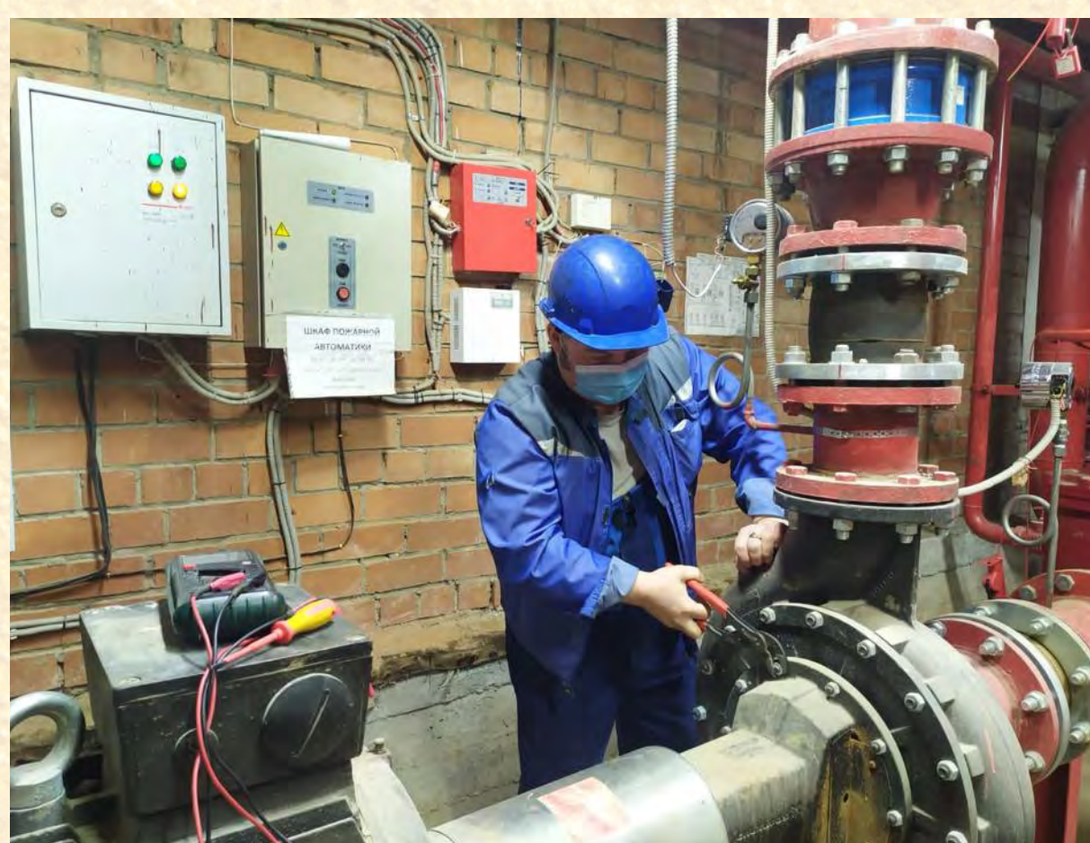
На фото: Специалист Коми республиканского отделения ВДПО проводит проверку соединений противопожарного водопровода на Комбинате
